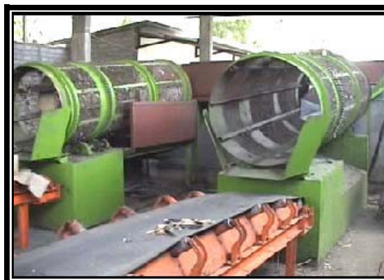
Gambar 2.1. Instalasi Pengolahan Sampah Tuntas (IPESATU)
